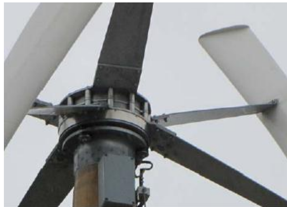
Abbildung 3: Verbindung des Mastes mit dem Maschinenteil
