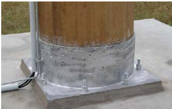
Abbildung 5: Fußpunkt der Windkraftanlage
